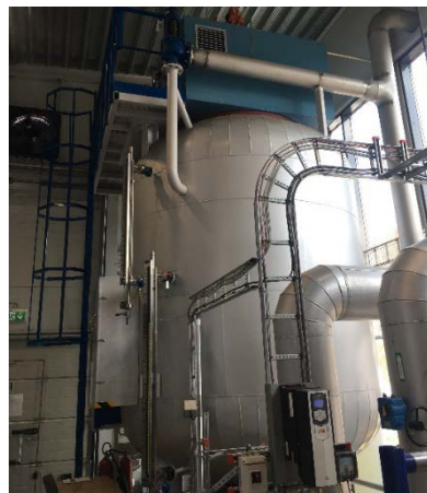
Hetvattenpanna typ P2H för miljövänlig fjärrvärme.
